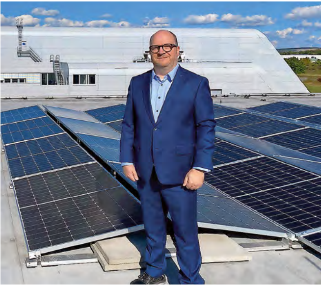
SKF-Geschäftsführer Thomas Burkhardt an der neuen PV-Anlage, die 17 Prozent des Strombedarfs für das im Hintergrund sichtbare „Sven Wingquist“-Prüfzentrum für Großlager deckt.
