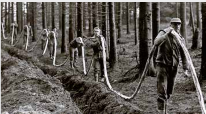
Wie in den frühen Unternehmensjahren ist auch heute die Stromversorgung in der Rhön eine Gemeinschaftsaufgabe. Bild: Archiv ÜW Rhön
