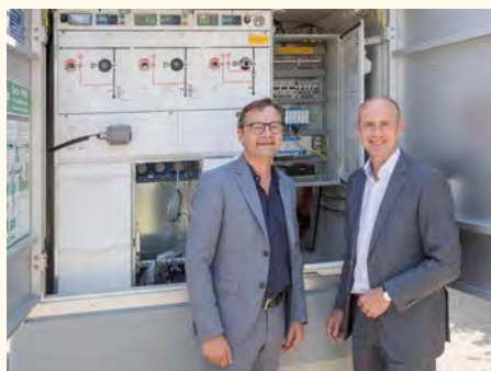
Vorstandsvorsitzender Reimund Gotzel (links) und Technikvorstand Dr. Egon Westphal (beide Bayernwerk) stellen die intelligenten Komponenten der neuen Ortsnetzstation vor.
